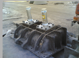
Kömür Değirmeni Hidrolik Sistemi
