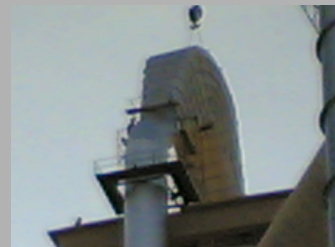
Ön Isıtıcı Gaz Kanalları
