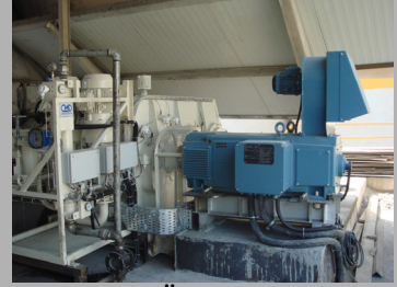
Fırın Tahrik Ünitesi
