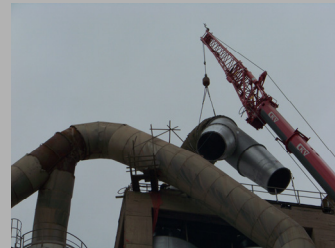
Ön Isıtıcı Gaz Kanalları
