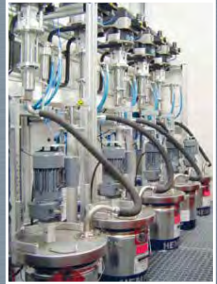
Farbförderanlage mit Deckelhubeinrichtungen für Hobbocks, Elektrorührwerken und Wagner Kolbenpumpen.
